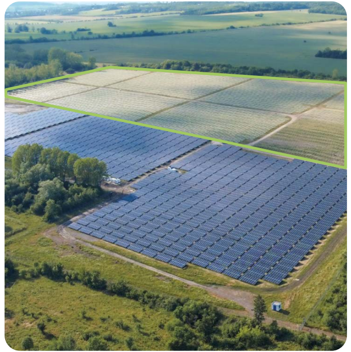
Photovoltaikpark „Gotha“ nach dem Revamping. Quelle: CEE Group
