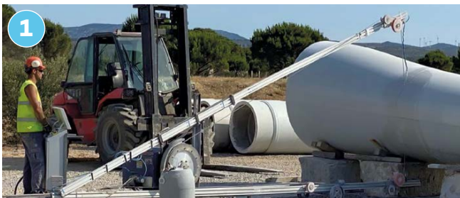
1 Zersägen der Blätter in Abschnitte mit Diamantsägeblatt. Bewässerung zur Staubvermeidung und zum Auffangen der Sägereste
